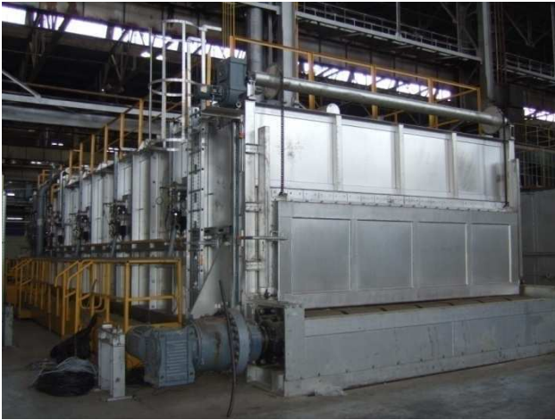
Schmiedeanwärmofen, Durchsatz 8 t/h, offen Erdgas beheizt, Ofeninhalt bis 60 t, Schmiedestücke einzeln bis 2 t
