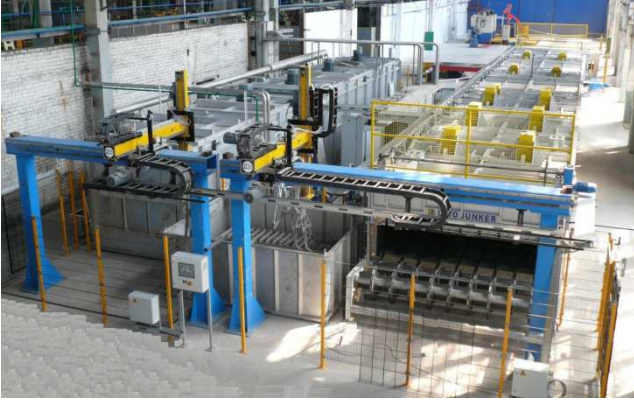
Vergüteanlagen für geschmiedete Aluminium-Räder, bestehend aus Lösungsglühofen (2 Reihen), Wasser-Abschreckbecken, Warmauslagerungsöfen (4 Reihen), Be- und Entlade-Manipulatoren.
