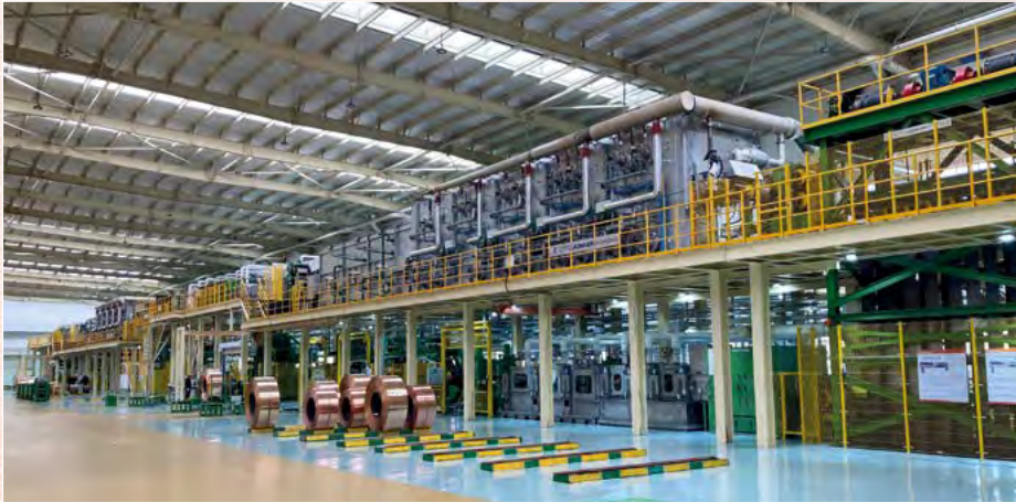
Bandbehandlungsanlage zum kontinuierlichen Entfetten, Glühen und Beizen
